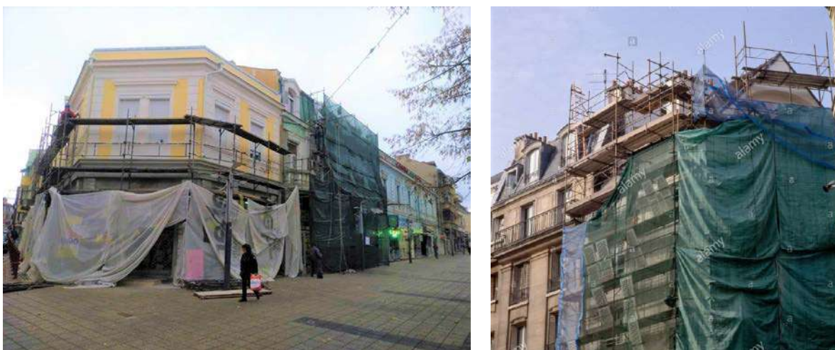
Фиг. 1. Бургас [16], и Париж [17], - нарушаване на параметрите на екстериора през периода на ремонт и реставриране на фасада на сграда
